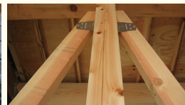
▲柱の接合部分の補強金物
